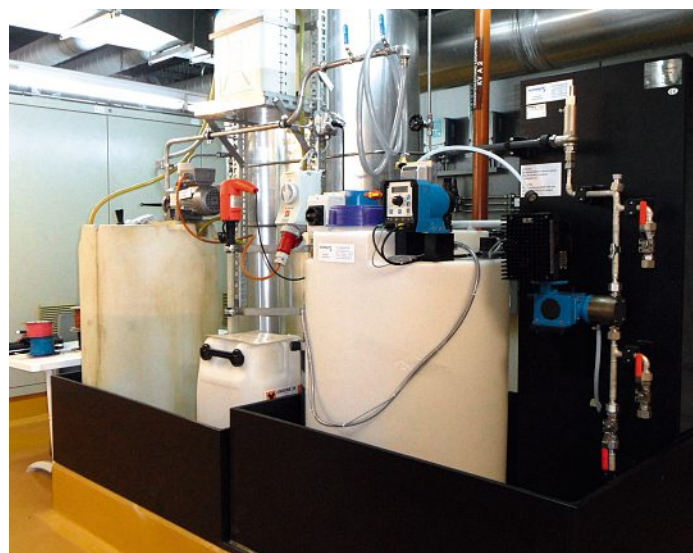
Dosieranlage Ammoniak-Dosierung für Speisewasser und Natronlauge/Trinatriumphosphat-Dosierung für Kesselwasser.
